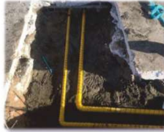
Yer altı çelik boru tesisatları
